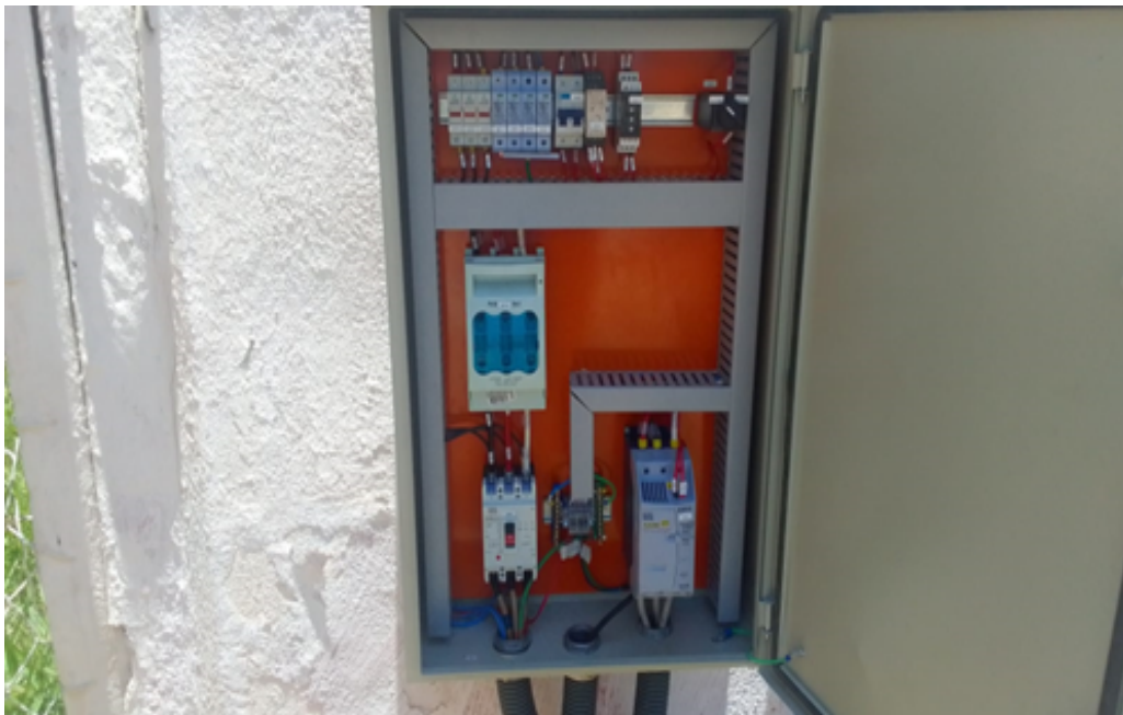
NOVO PAINEL ELÉTRICO INSTALADO
