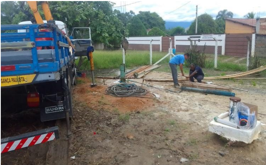
BOMBA NOVA EM PROCESSO DE INSTALAÇÃO
